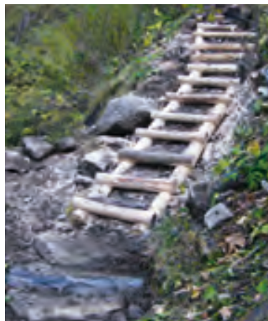
Einbau einer Holztreppe mit Erdkontakt. Hier ist die Verwendung dauerhafter Hölzer wichtig.
